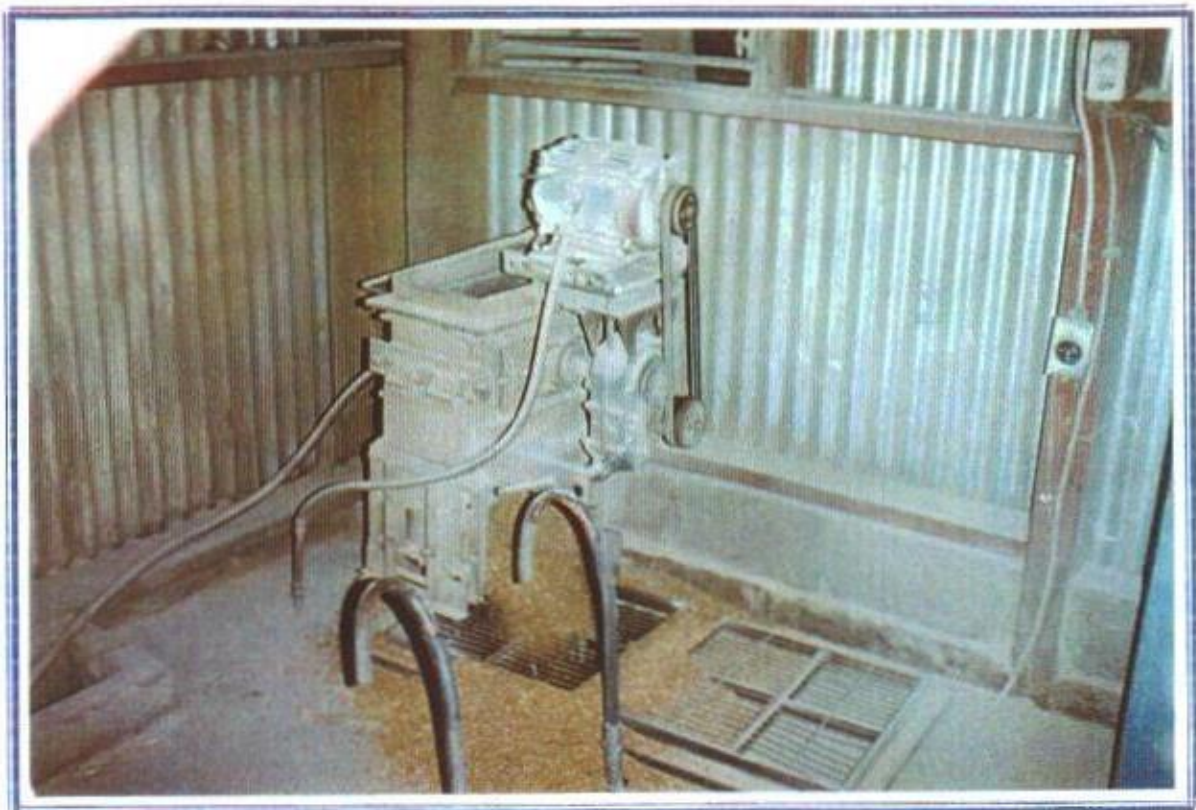
VISUAL 12. ENTRADA PARA LOS ELEVADORES DE TRIGO.
